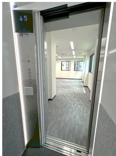
〔エレベーター〕
